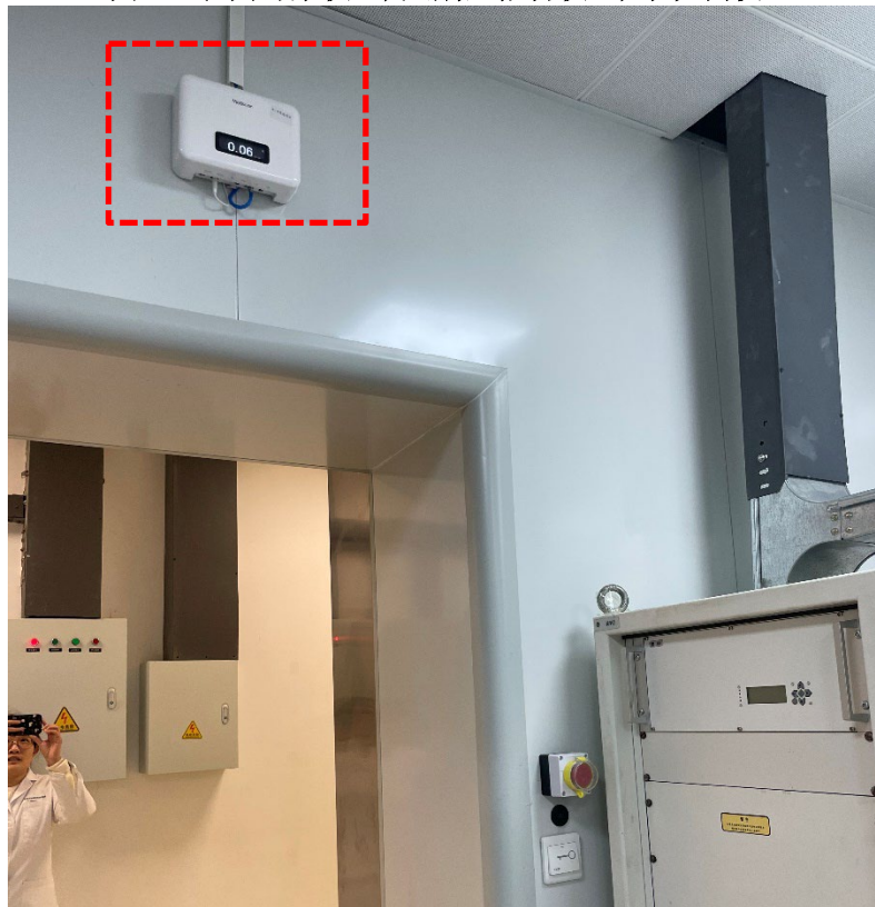
加速器机房内
